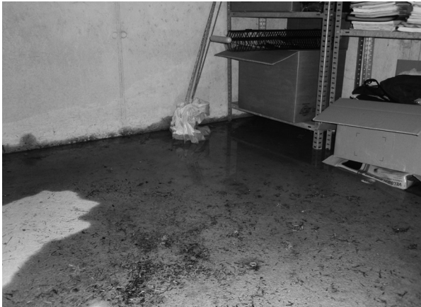
Abbildung 5 Feuchteintritt durch Fuge zwischen Kellermauerwerk und Bodenplatte
